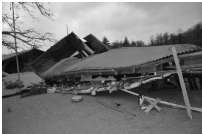
Figura 4: Colapso del techo del quiosco de la Aduana argentina por sobrecarga de ceniza y nieve, en el paso fronterizo Cardenal Samoré. Junio de 2011.
